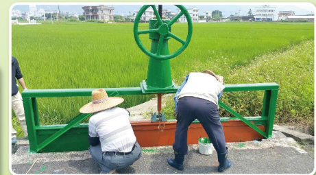
▲水門上漆情形
