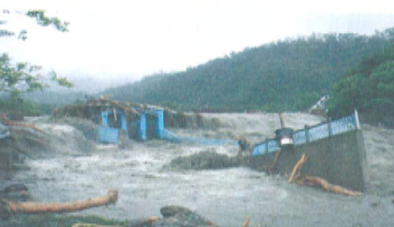
◎糞箕湖圳渠首工沖毀情形
