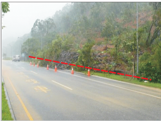
冬山圳幹線林寶春支線(紅線處)遭走山掩埋情形
