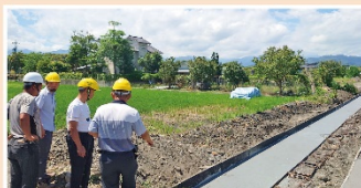
▲「大洲中溪洲7-8小給等更新改善工程」主要結構物襯底施作狀況
