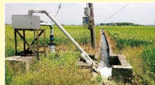
▲啟動地下抽水設備
