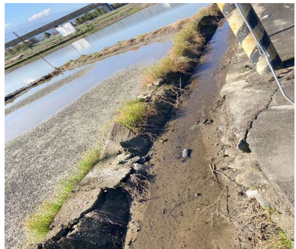
說明：南富8工區 南富八主給 8-3 小給
