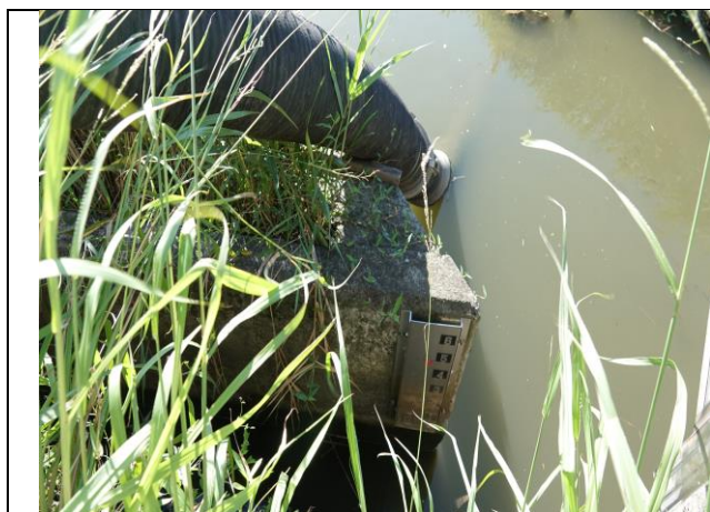
時間：114 年 6 月 11 日 說明：大眾四號抽水機
