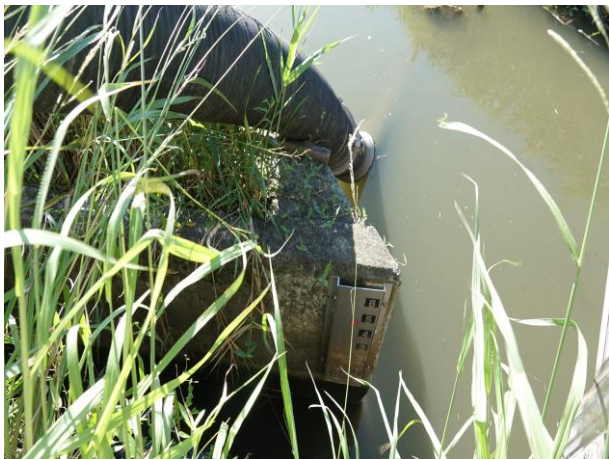
四結-01 工區：大眾四號抽水機 (114 年 6 月 11 日)
