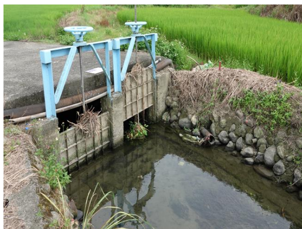
二結-05：冀箕湖圳排水下游制水門
